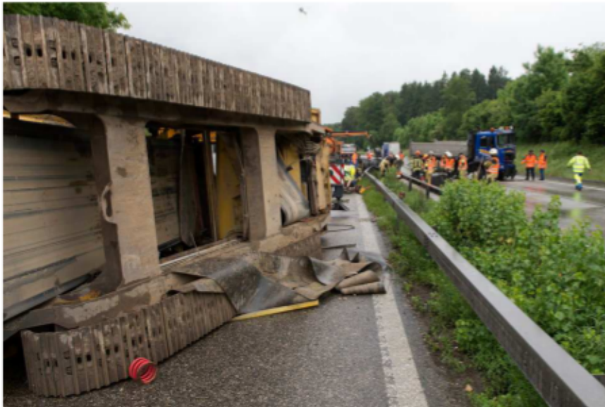
1 | 14 Die Baumaschine sperrt die Strasse in Richtung Zürich: Die Unfallstelle in Luterbach. Bild: Keystone (14 Bilder)
